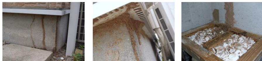
平成23年5月被害発見 粕屋郡篠栗町 イエシロアリ被害 基礎パッキン工法の建物に外基礎から侵入した状態です。
