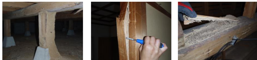
平成23年6月被害発見 福岡市西区 イエシロアリ被害 床下の束柱から侵入し、化粧柱を加害しています。室内の押入の部材を加害しており、天井裏・室内・床下全てに被害が出ています。
