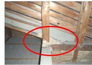
2階天井裏の被害部です
