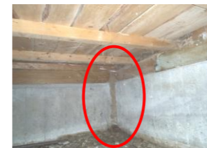
床下の蟻道です
