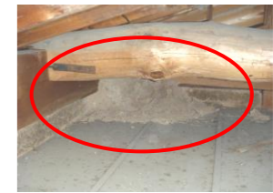
2階天井裏の分巣です
