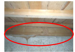
床下の蟻道です
